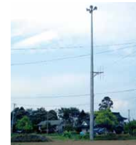
海へ向けて設置されている気仙沼の防災無線。
